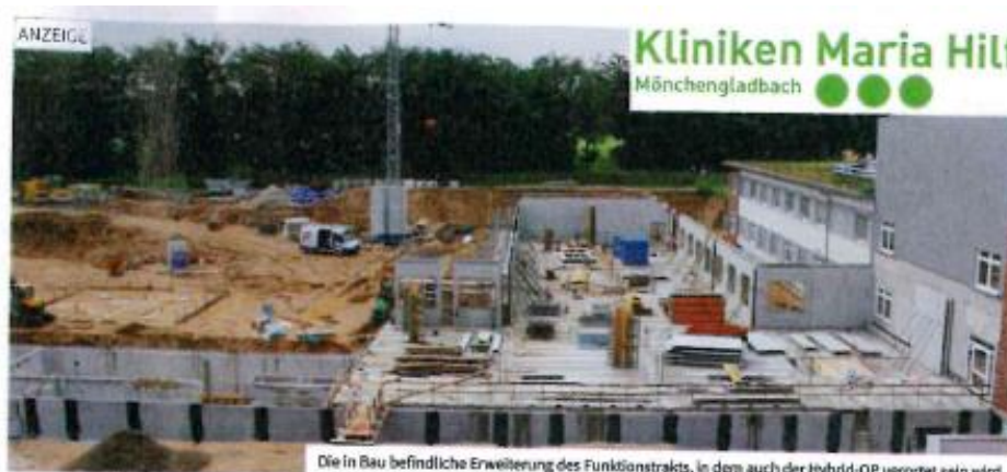
Die in Bau befindliche Erweiterung des Funktionstrakts, in dem auch der Hybrid-OP verortet sein wird.
